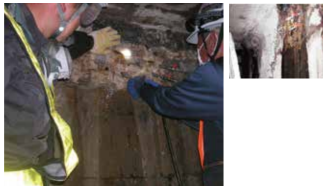
写真③ 地下道での漏水状況。毎分数十%の漏水を極めて短時間で止水した。
